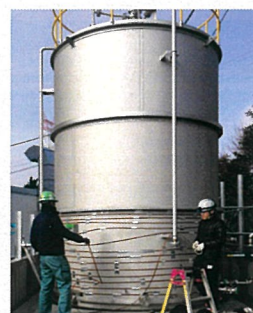
タンク下部の3分の1にヒーターを取付け、樹脂が自然対流によりタンク内を循環し、均一な温度分布を実現
